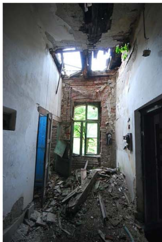
38_fszt-i helyiség a beszakadt tetőnél, 2014
